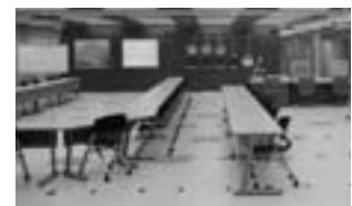
防災行政用無線統制室
