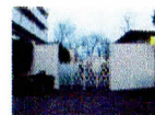
広場を仮設設置エリアとして全面借用 周囲をフラットパネルにて仮囲いし キャスターゲートを設置
