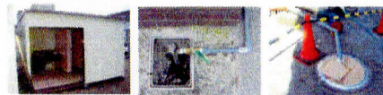
仮設エリア内へ 仮設水洗トイレ、手洗いシンク、沈殿槽を設置 ブースタイプとします 散水栓より分岐借用
